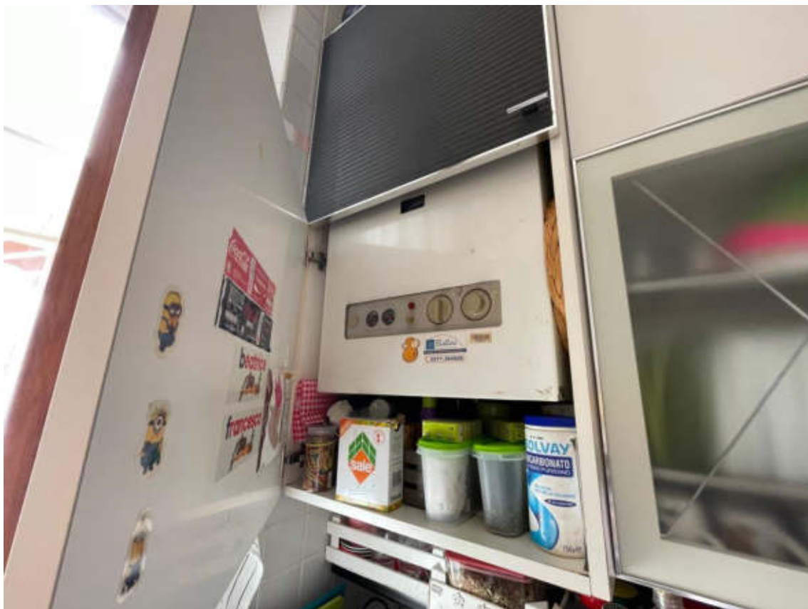
Vista caldaia ubicata all'interno della cucina
