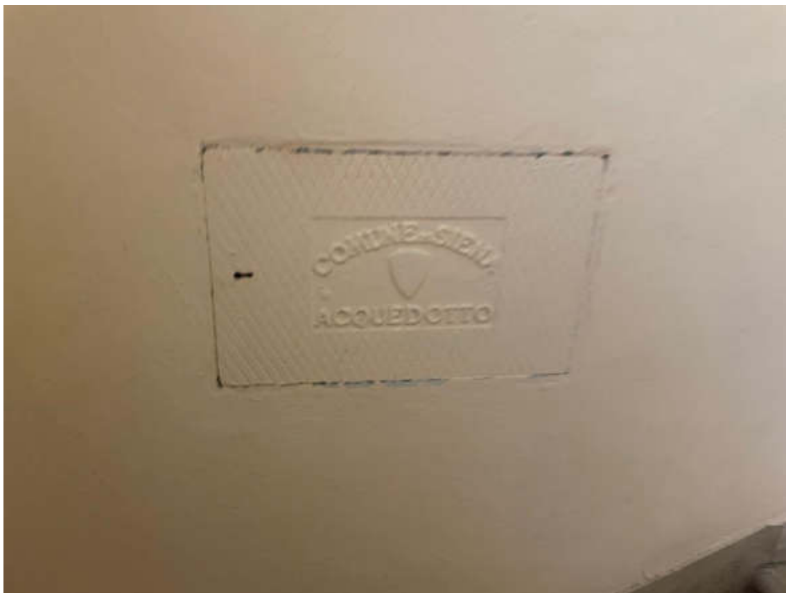
Vista vano contenete l'unico contatore generale dell'acqua
