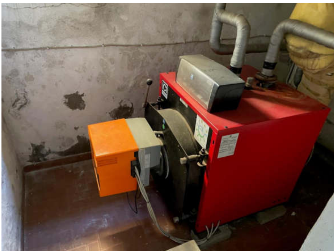
Vista caldaia per il riscaldamento a comune con altra u.i.u. non pignorata
