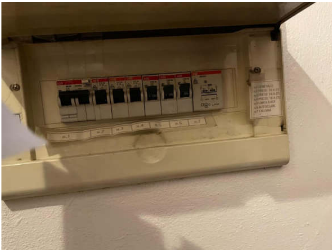
Vista quadro elettrico interno
