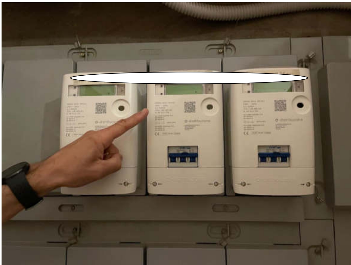
Vista quadro elettrico a servizio dell'appartamento sub 14
