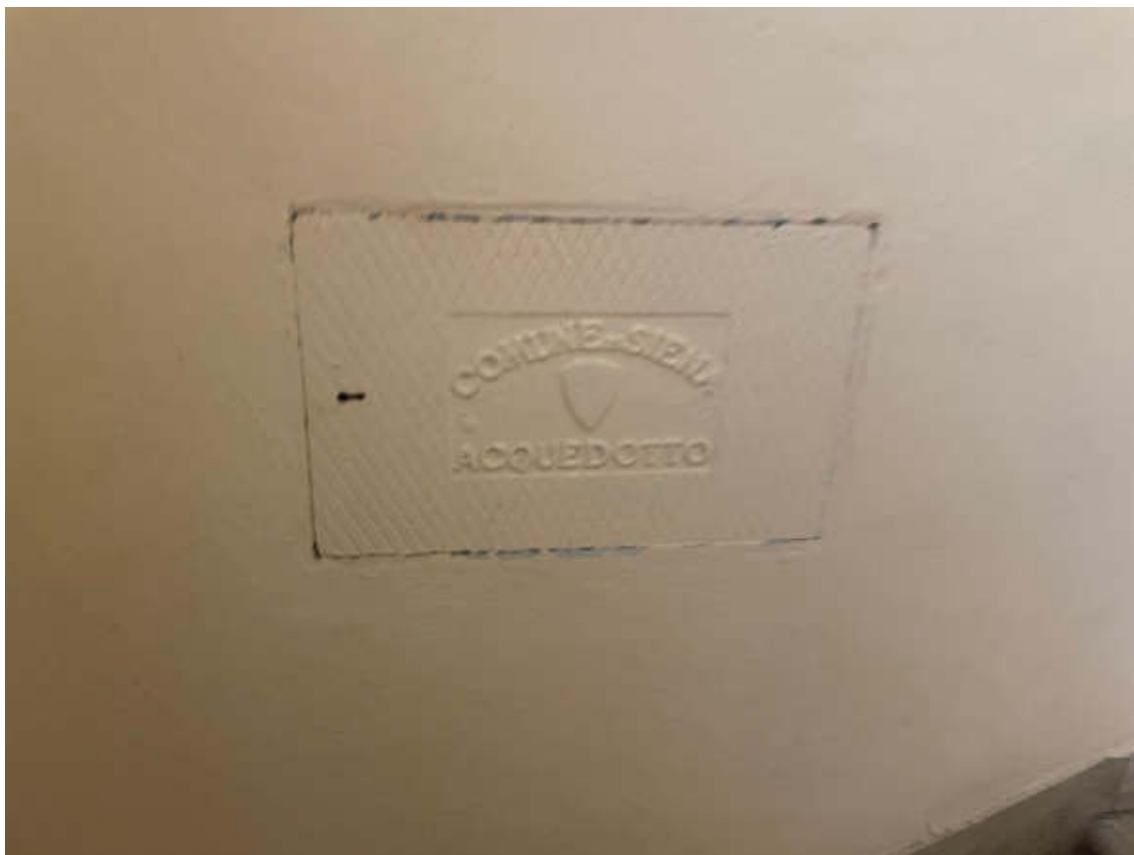
Vista vano contenete l'unico contatore generale dell'acqua
