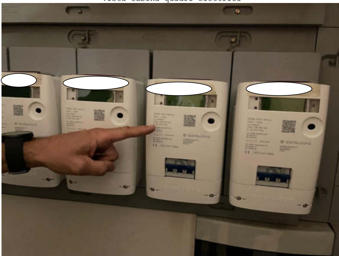
Vista quadro elettrico a servizio dell'appartamento sub 12
