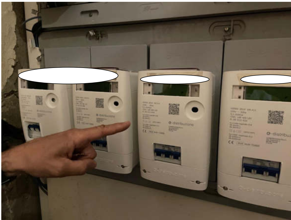
Vista quadro elettrico a servizio dell'appartamento sub 13
